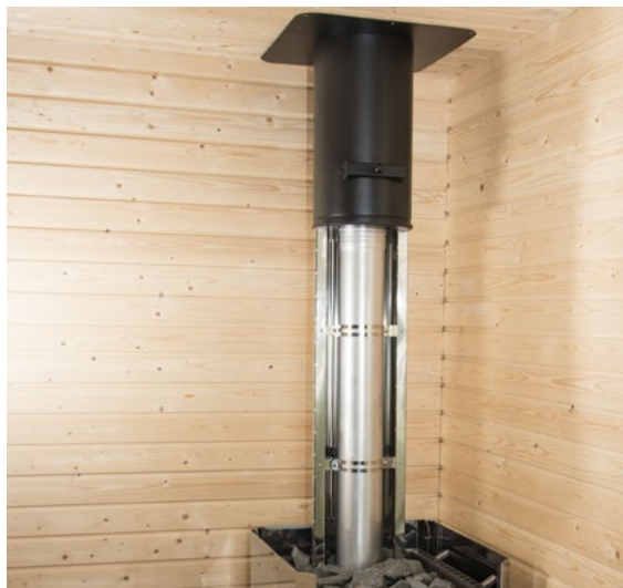
Kuvassa mukana hormisuoja
